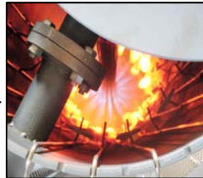
ハンガーを処理室内へ 投入しガス化燃焼
